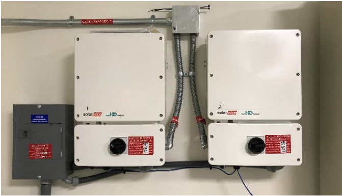
Two Solar Edge Inverters
